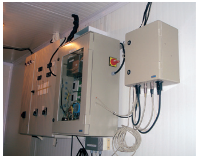
Συσκευή ελέγχου πιλοτικού θαλάμου.
