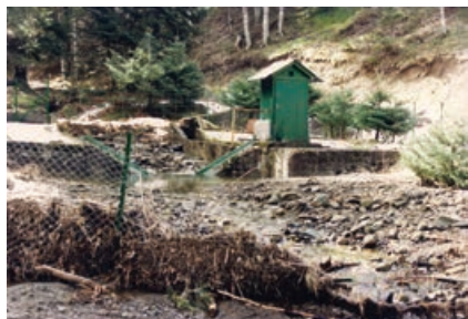
Κατεστραμμένος υδρομετρικός σταθμός από πλημμύρα στο ελατοδάσος Ενρυτανίας (ύψος βροχής καταιγίδας 200 mm, περίοδος επαναφοράς της 315 χρόνων)
